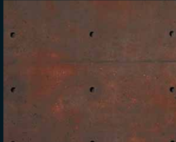
M-172 · Rusty Concrete Wall Panel Panel Cemento Oxidado
